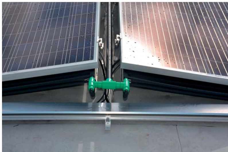
Bild 2: Detailansicht vom Kraftdach. © Kraftwerk Solutions GmbH
